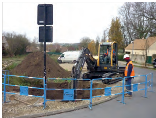
Travaux d'interconnexion à l'angle des rues Simon de Montfort et Fontaine de Ville
